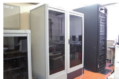
ネットワークサーバ群 Network Servers
