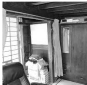
写真4 住居の柱の傾斜
