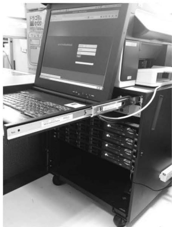
図3 システム外観
