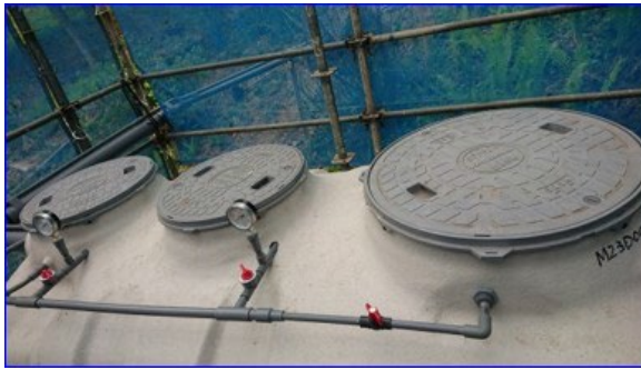
図3 浄化槽の写真（上部より） 左側から厨房排水が流入し、右側へ抜けていく 構造である。写真手前の配管がブロワからの 送風管である。
