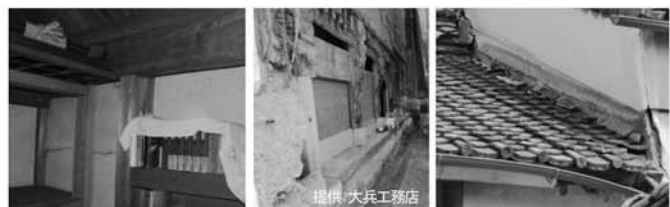
写真1 土壁の水平ひび割れ
