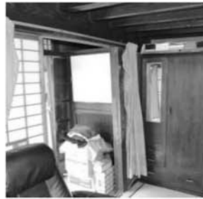
写真4 住居の柱の傾斜
