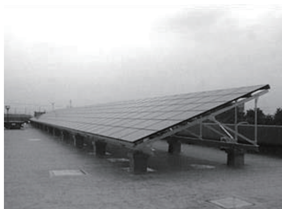
図3 校舎屋上設置の30kW太陽電池アレイ
