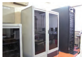
ネットワークサーバ群 Network Servers
