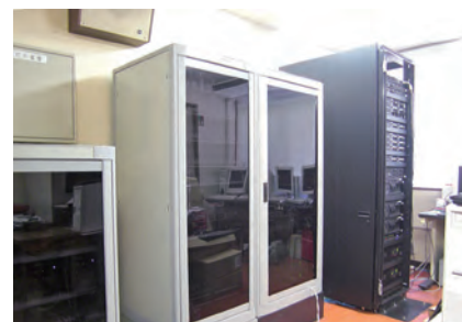
ネットワークサーバ群 Network Servers
